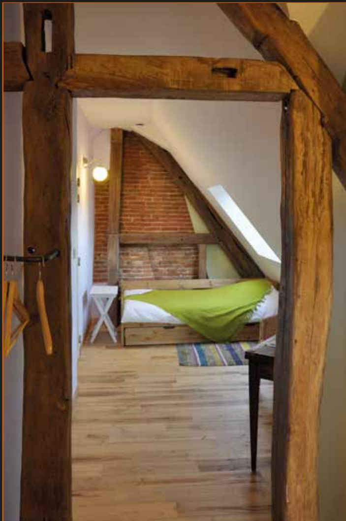
Combles isolées en fibre de bois (source: Sylvain Moreteau)
